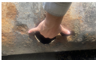
漏水箇所(こんなに大きな穴が!!)
