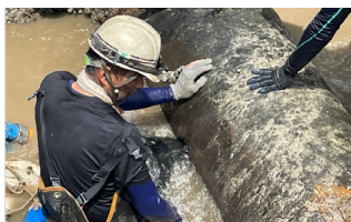
漏水箇所の特典
